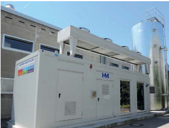
Abbildung 10.10 Maschinencontainer und Eisbreispeicher
