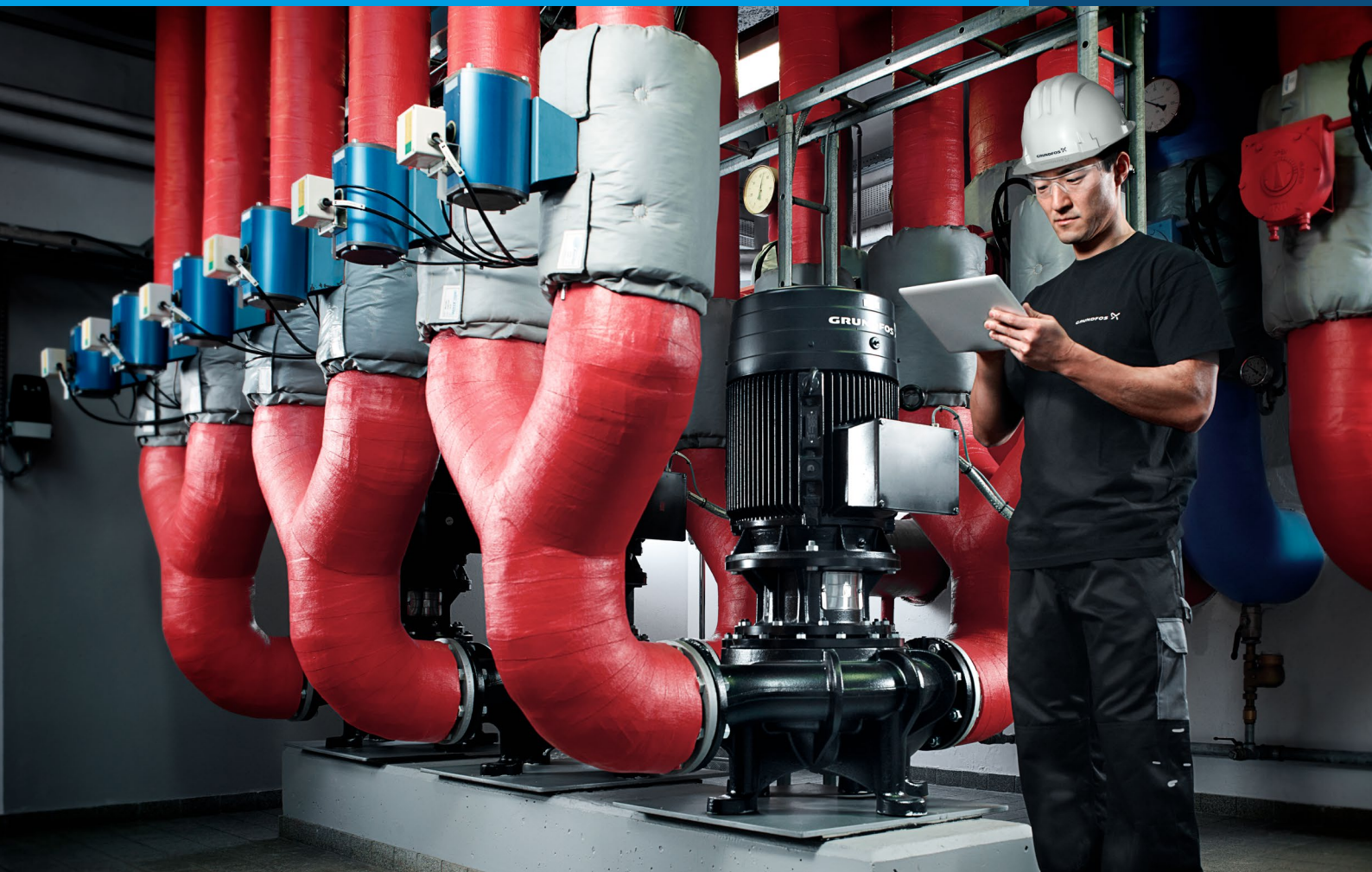
Pumpensteuerung mit Mobilgerät
